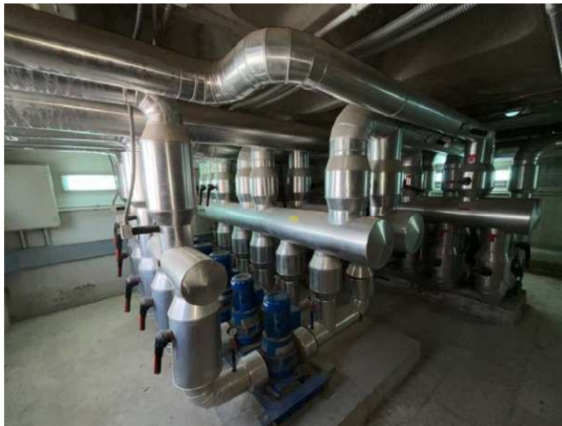
Ilustración 3: Estado actual del cuarto de instalaciones
