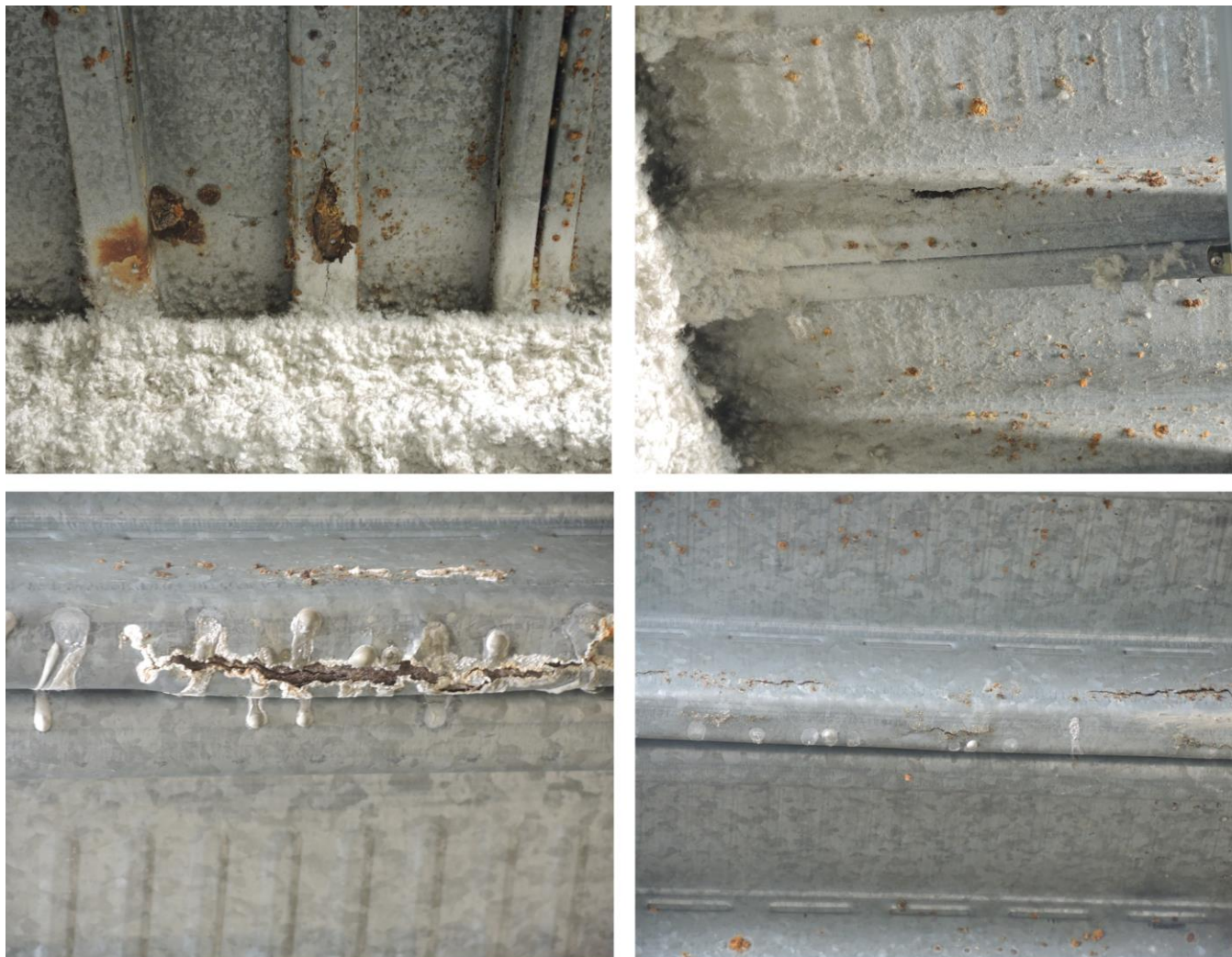
Figura 1. Patologías observadas en la chapa del forjado colaborante situada en la zona de la caja escénica. EL+27.20.
