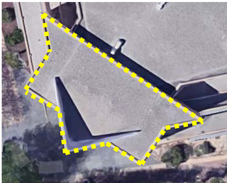
Zona afectada de la cubierta
